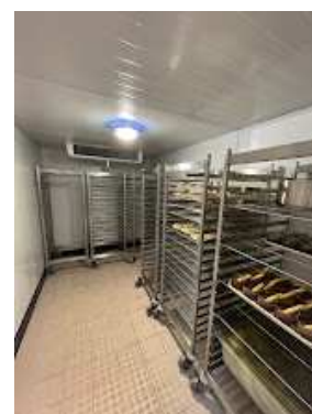
Une chambre froide
